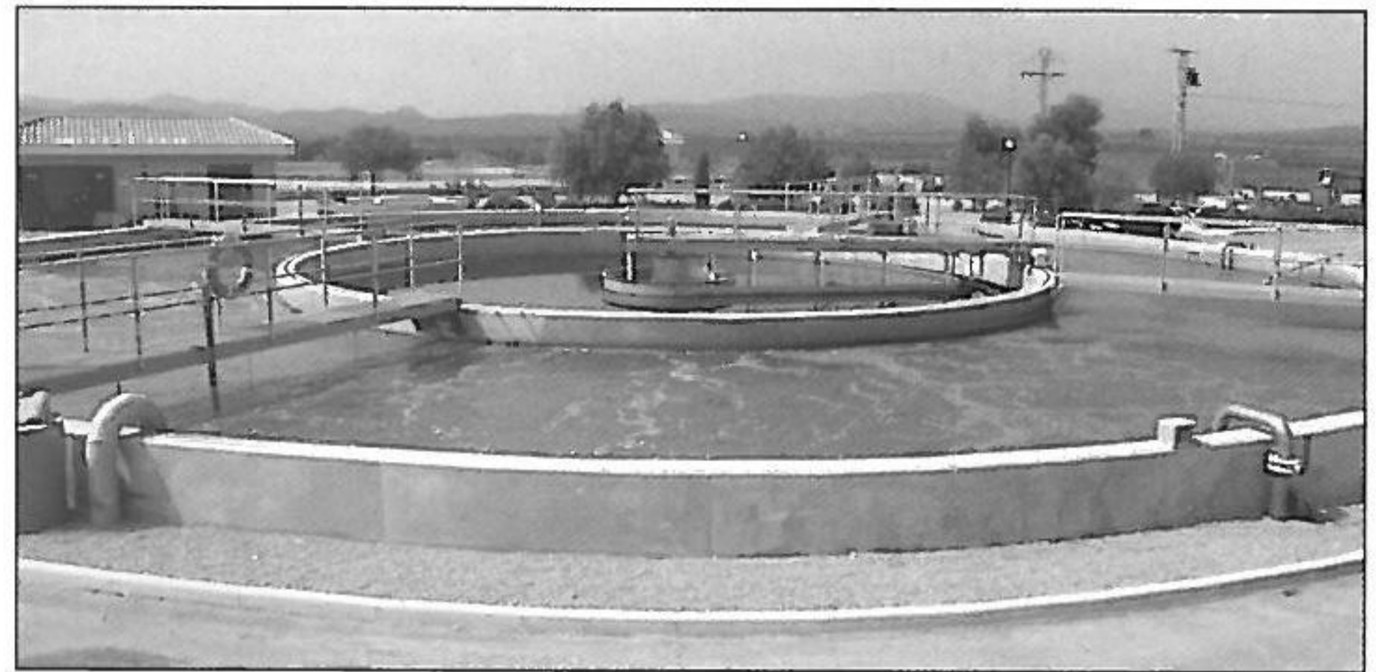
Imagen de la Estación Depuradora de Aguas Residuales de Pinoso en funcionamiento. Las aguas depuradas serán reaprovechadas para riego.
